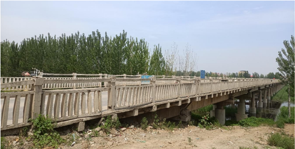
图 5.1.3-1 史各庄镇老桥（V 类危桥）
